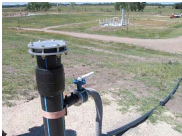
Foto 4. Cabezal de pozo de captación de la Planta de captura de biogás, Olavarría, Prov. Buenos Aires
